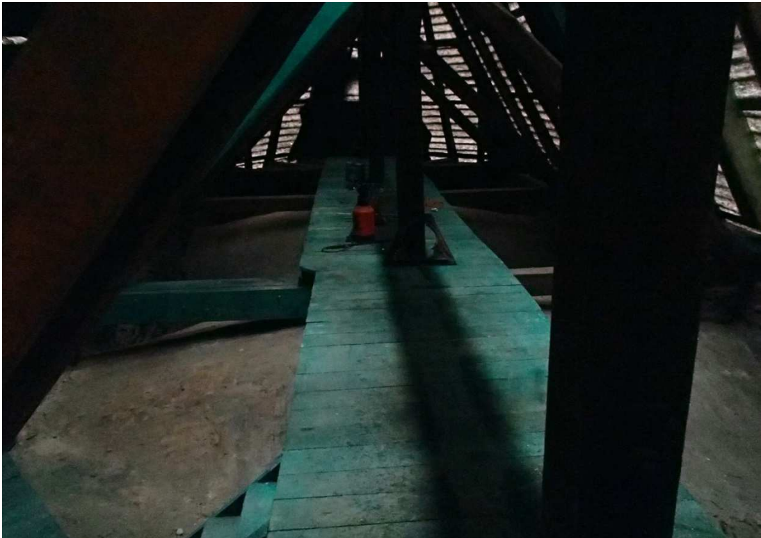
Dachstuhl-Wartungsbrücke über Langhausgewölbe, Foto: K. Atykow, Spätsommer 2013
