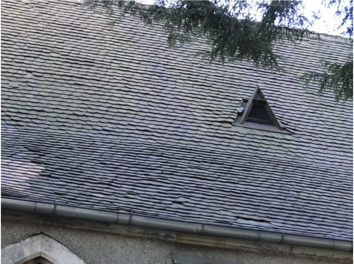
Ausschnitt Nordseite Langhausdach vor der Sanierung, Foto: K. Atykow, 2012
