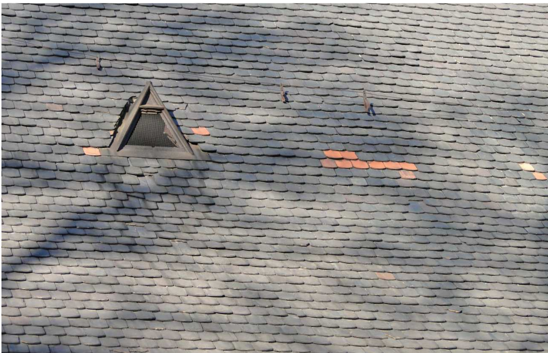
Unebene Dachfläche Südseite Langhaus vor der Sanierung, Foto: K. Atykow, 2012
