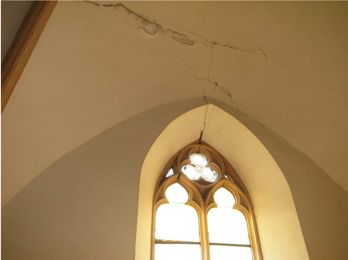
Risse an der Innenraumschale, Spätsommer 2012
