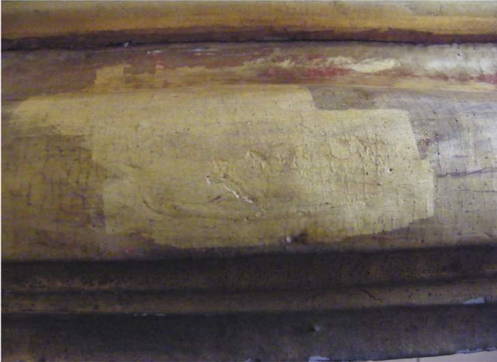
3. Fragment dużego półwałka. Widoczne matowe przezłocenie położone na ubytki i zniszczenia oryginalnej pozłoty. Stan przed konserwacją.
