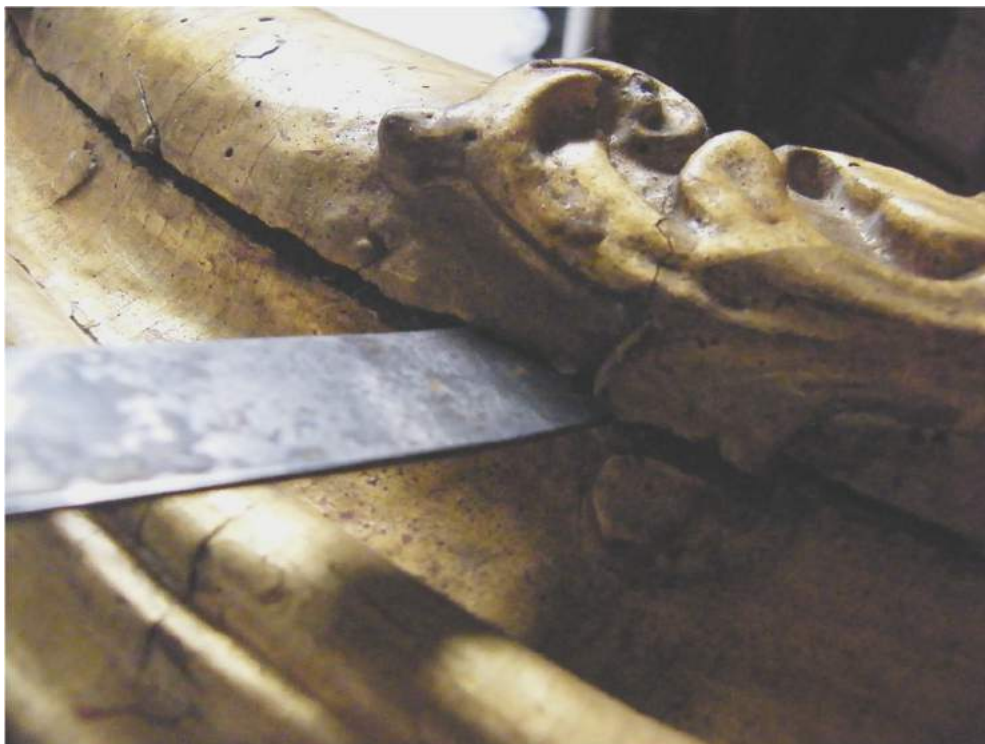
7. Odspojenie górnej części półwałka. Rozklejenie konstrukcji.
