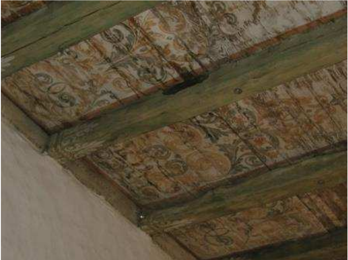
Ausschnitt geschädigte Deckenbretter in situ, Mai 2010
