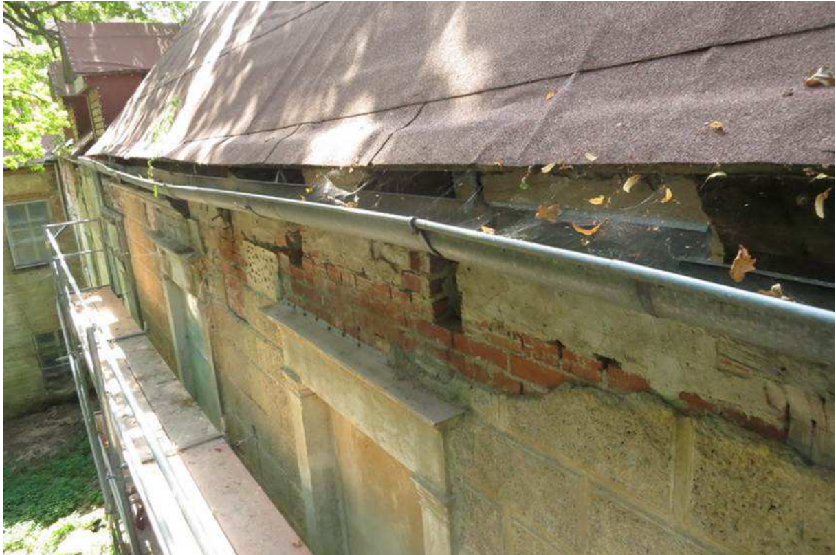
Sicherung Nordwestturm: Dachrinne vor der Reparatur Sommer 2014 (Foto: W. Jäger)
