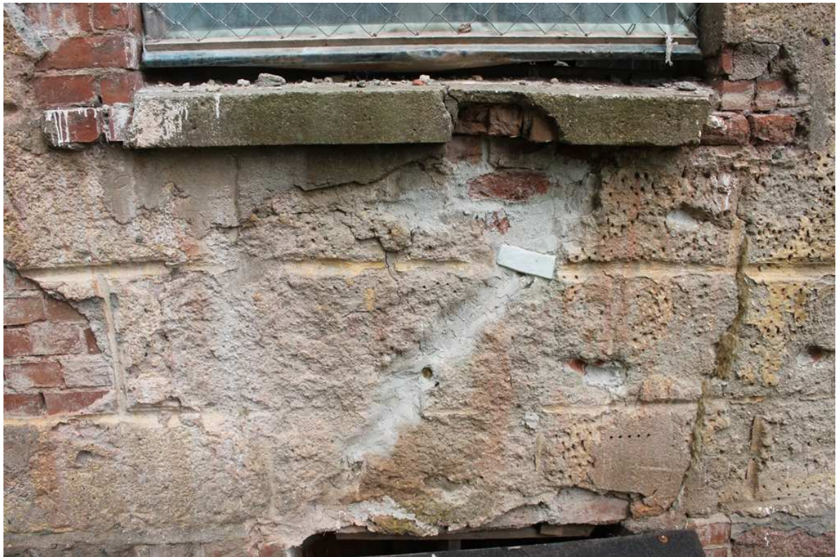
Am Westflügel von Schloss Steinort nach Rissvernadelung gesetzte Gipsplombe, Sommer 2015
