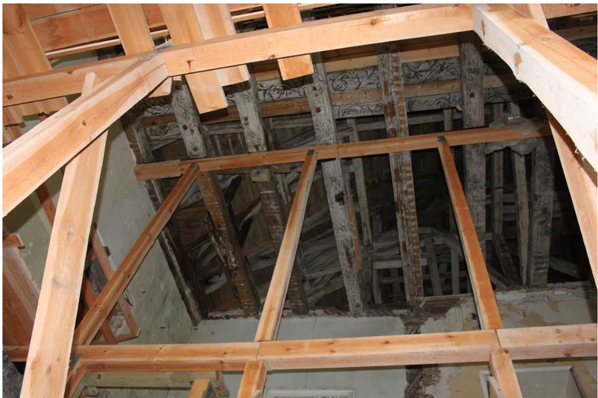
Blick im Kernbau von Schloss Steinort aus dem EG mit den Deckenbalkennotabstützungen in das erste OG, Sommer 2015
