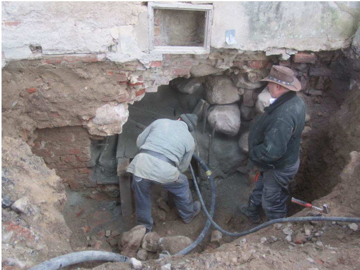
Sicherung Außenwand Keller 1.01 und 1.02 des Kernbaues (Mittelbau) von Schloss Steinort, Winter 2014 (Foto: W. Jäger)
