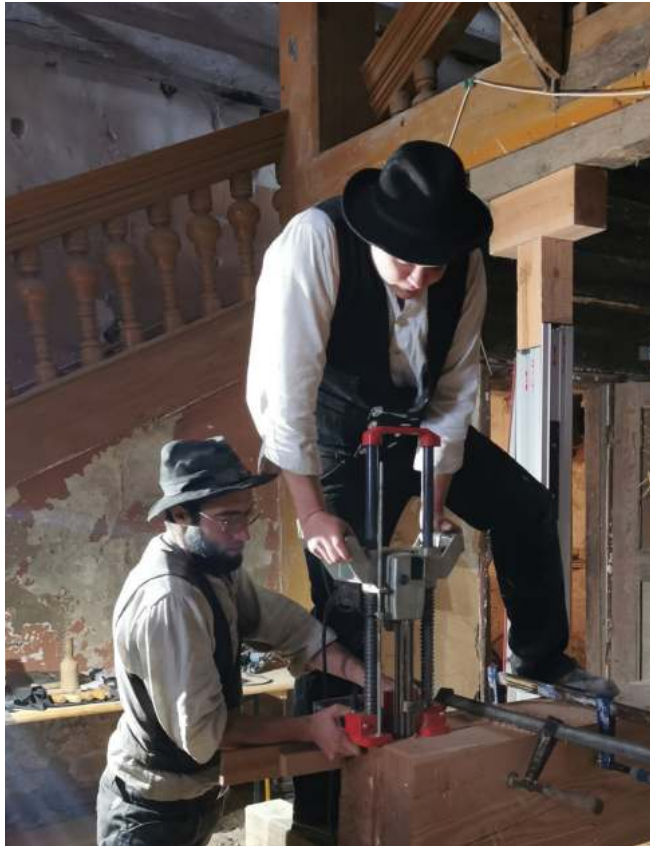
Naprawa na belce stropowej, sierpień 2021 r.
