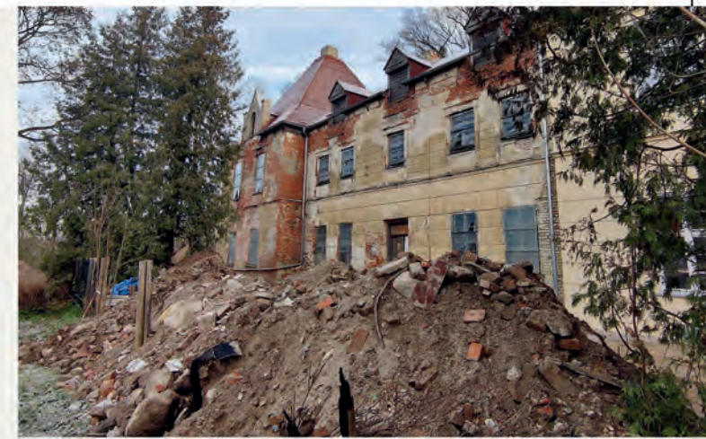
Sztynort (Steinort), Schloss (Ende 17. Jh., erweitert im 19. Jh. OPS-Förderprojekt seit 2009), sanierungsbedürftiger Westflügel, 2026
