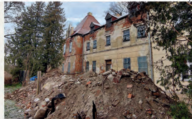
Sztynort (Steinort), pałac (z końca XVII w., rozbudowany w XIX w. projekt objęty wsparciem przez fundację od 2009 roku), widok frontu – pilnie wymagające remontu zachodnie skrzydło pałacu, 2026
